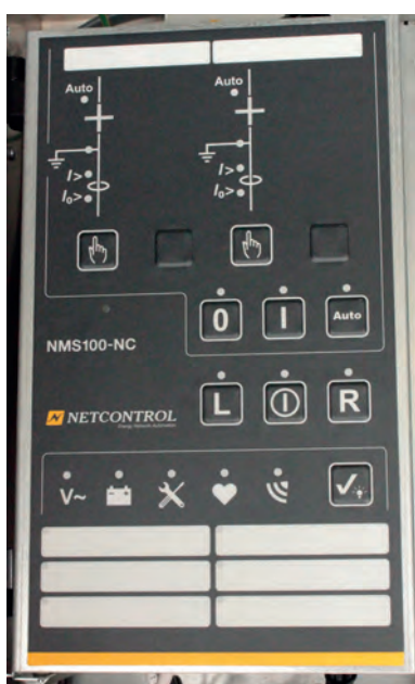
Panel operacyjny HMI164
