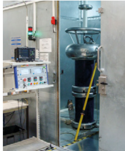
Station de mesures
